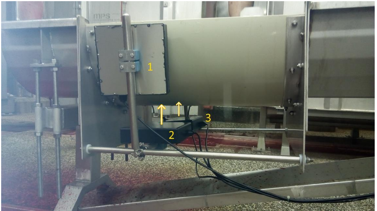
Abbildung 10: Antenneninstallation, Stand: 2. November 2018 (Bildquelle: © SFZU)
